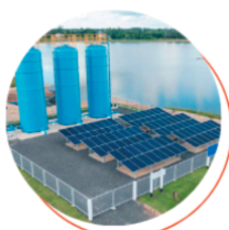
Sistema e Bombeamento Solar
